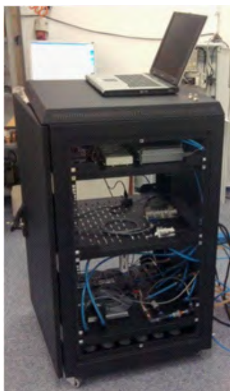
Rys. 4. Szafa pomiarowa umożliwiająca pomiary i ich digitalizację, widok zainstalowanej aparatury
