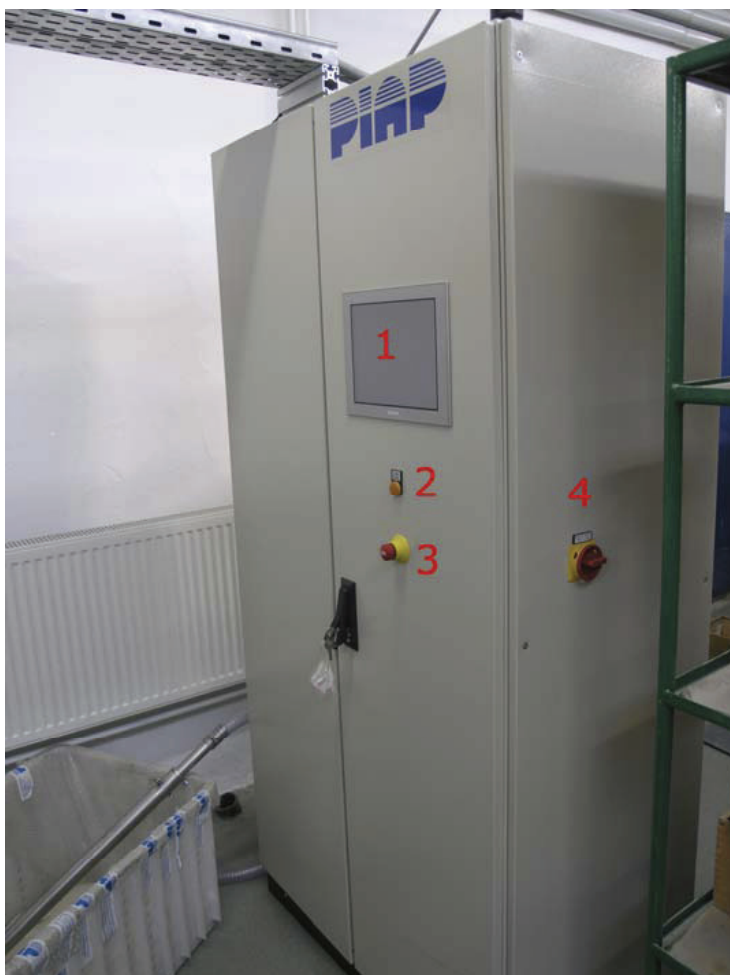
Fot. 3. Szafa sterownicza stanowiska. 1 – panel operatorski, 2 – kontrolka zasilania, 3 – przycisk Stopu Awaryjnego, 4 – włącznik główny
