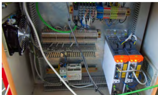
Rys. 4. Szafa sterująca Fig. 4. The control cabinet
