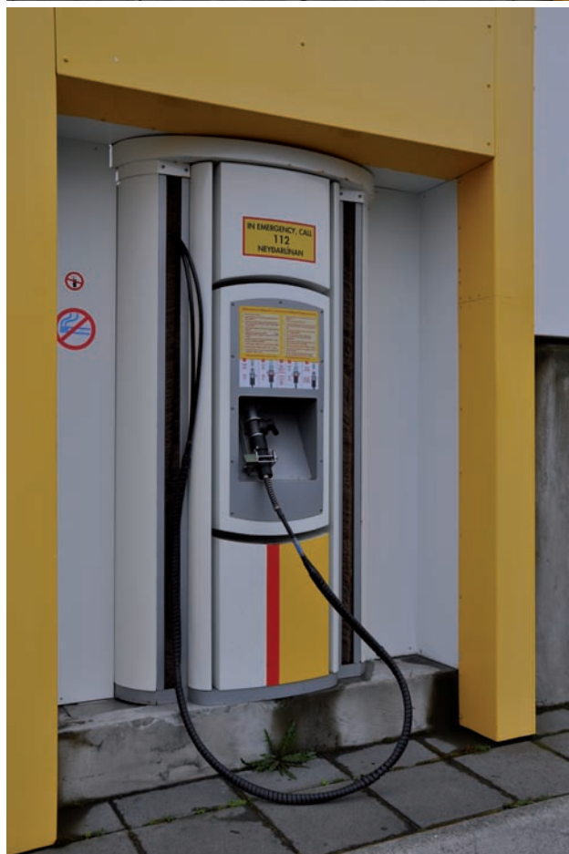
Rys. 15. Stacja wodorowa w Reykjavíku
