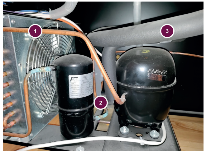
Rys. 3. Wnętrze komory agregatu z zaznaczonym umiejscowieniem sond temperatury (1, 2, 3)
