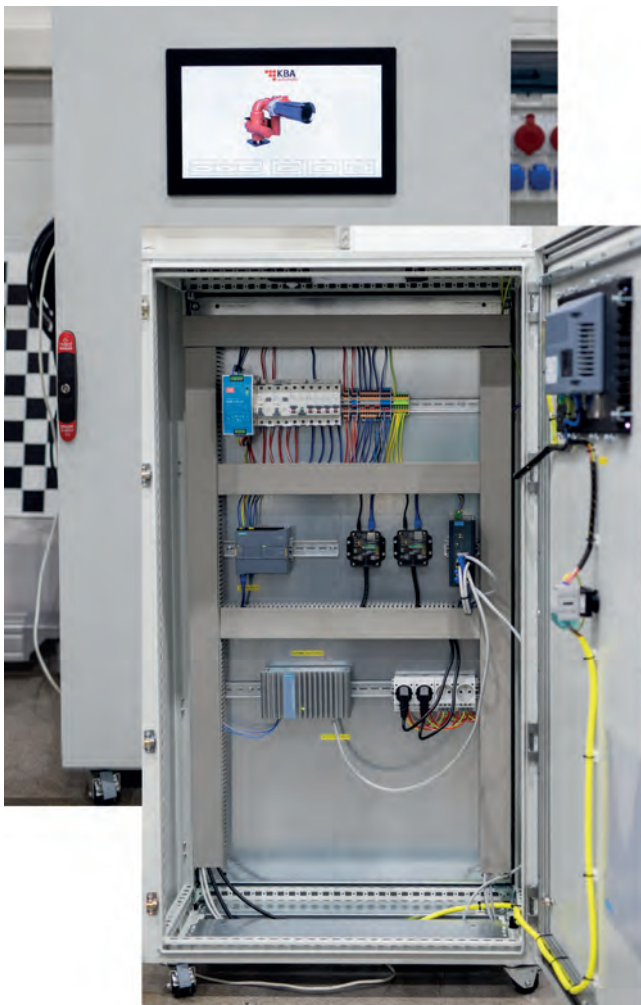
Fig. 13. Developed control cabinet Rys. 13. Opracowana szafa sterownicza
